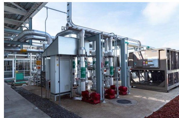
Sistema de enfriamiento de agua para planta OTC
