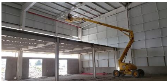
Dentro del Almacén de Materia Prima OTC
