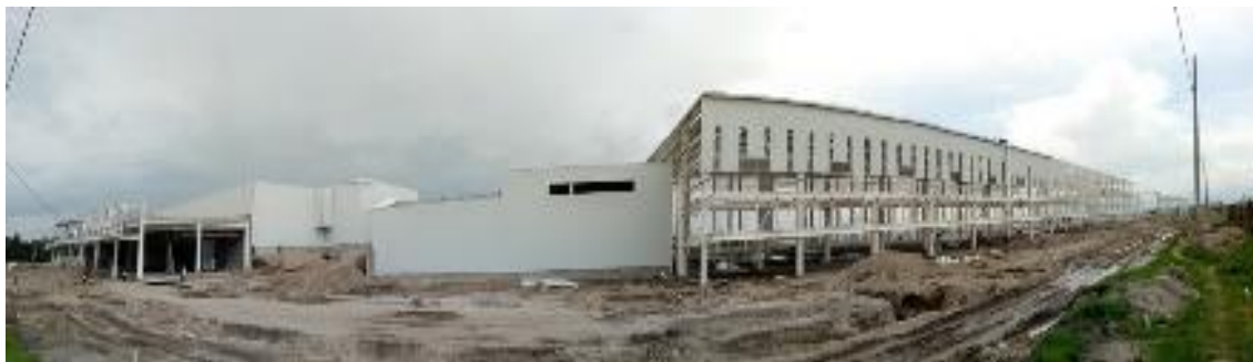
Planta OTC a un costado del Almacén de Producto Terminado
